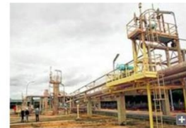
Planta de tratamiento de gas extraído del
